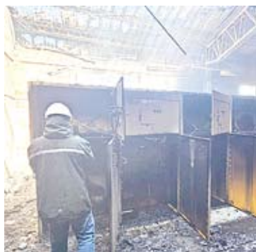
El interior de la Estación Transformadora del EPEN en Centenario
